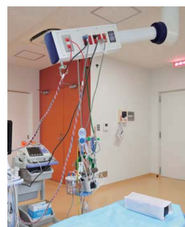
配線・配管は上部のシーリングペンダントに。
