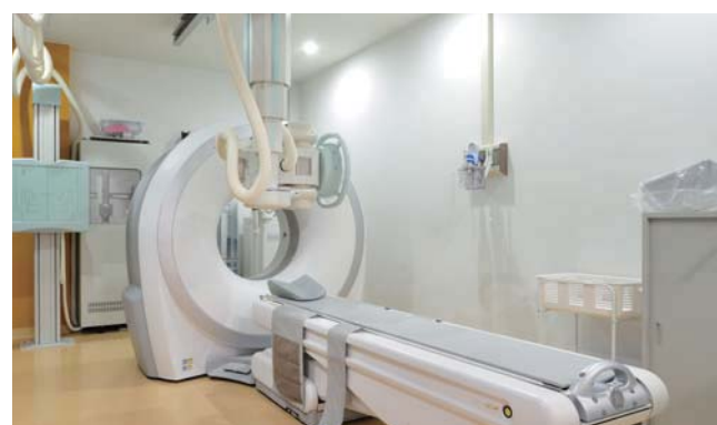
初療室の隣室に配置したCT。
